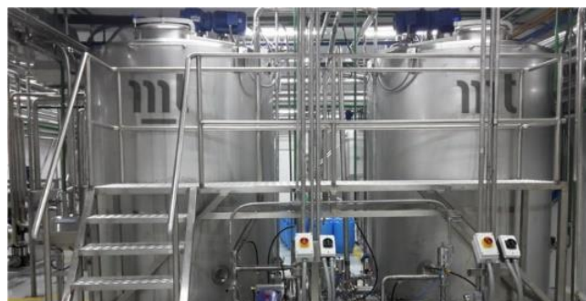
Tanques de emulsão com agitador
