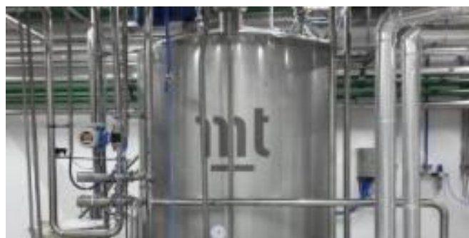
Tanques de fase aquosa
