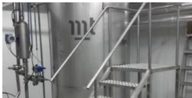
Tanques de fase oleosa
