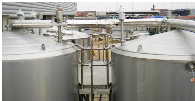
Tanques de Bases Grasas
