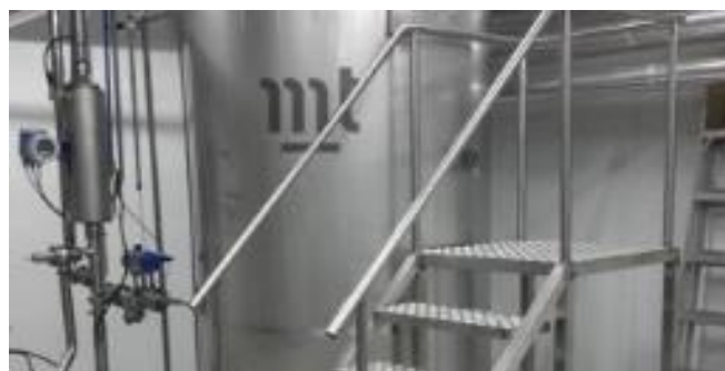
Tanques de fase oleosa
