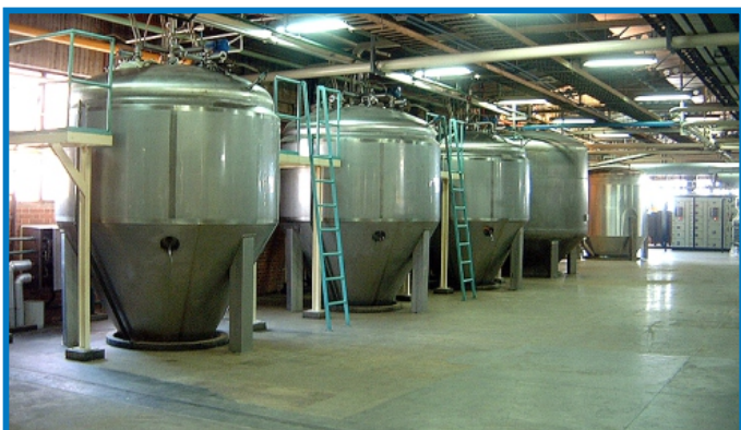
Silo de grasa
